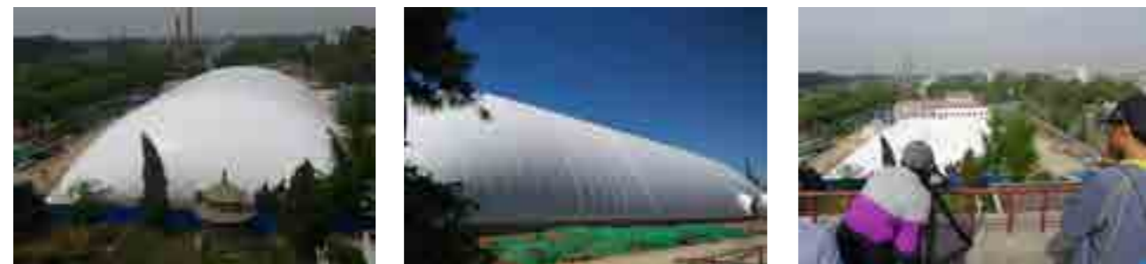
中国劳动关系学院综合馆建设现场，以及《探索》节目组拍摄
